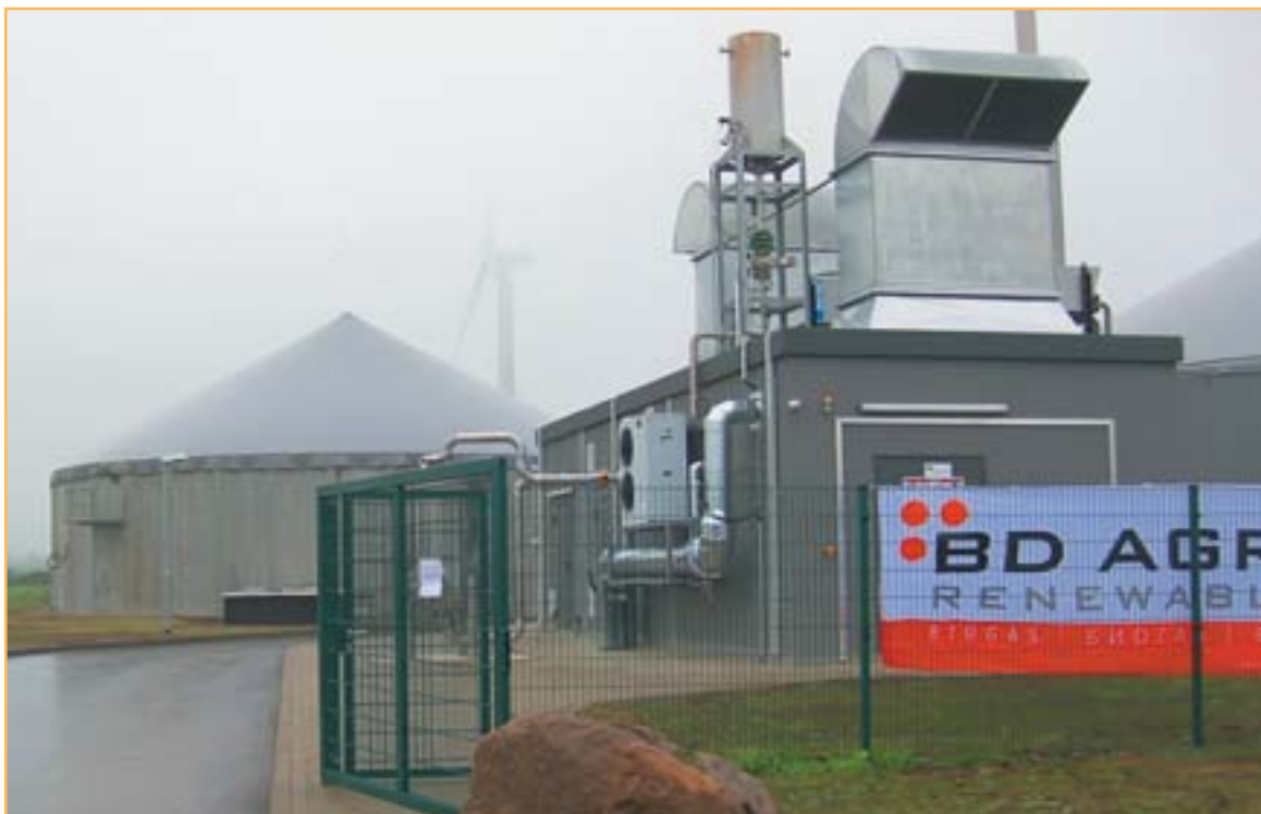
Фото. Биогазовая установка
