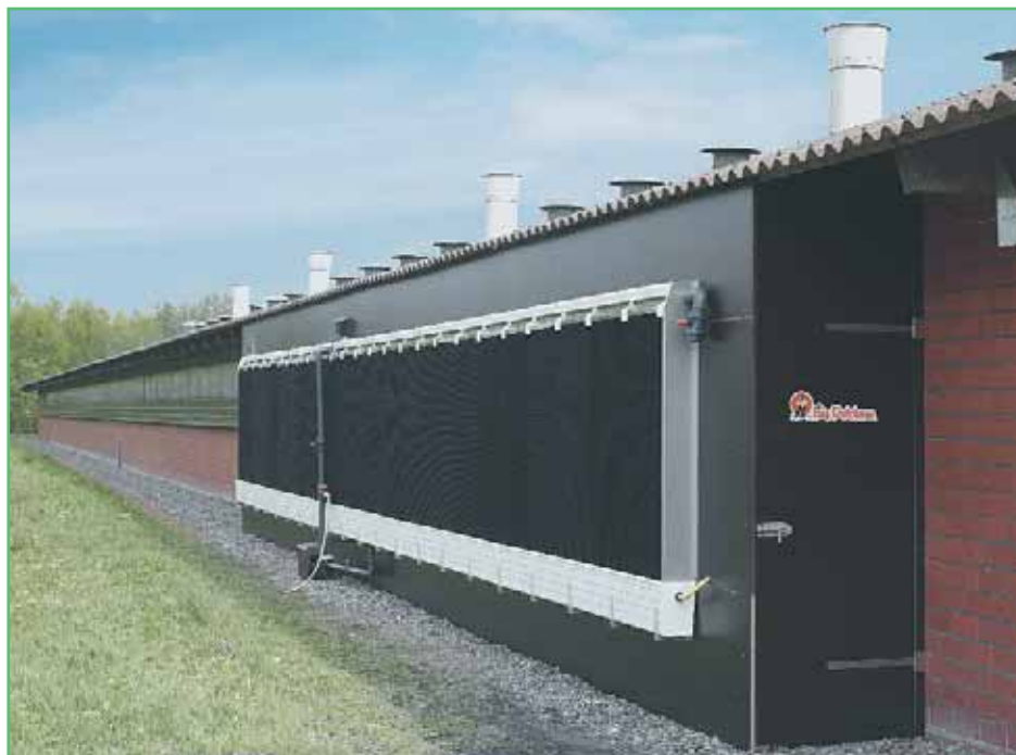
Фото 5. Система водяного охлаждения приточного воздуха
